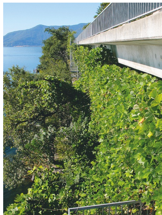
Kuzu e ailanto proliferano sotto la strada cantonale a Porto Ronco. Se non controllata la crescita di queste piante può danneggiare le infrastrutture.
